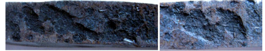
Рис. 1. Внутрішня поверхня експлуатованої труби викидної лінії свердловини
