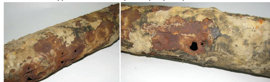
Рис. 1. Фрагменти підземного газопроводу низького тиску (Ø 60 мм) з наявними електрокорозійними дефектами типу "свиць"
