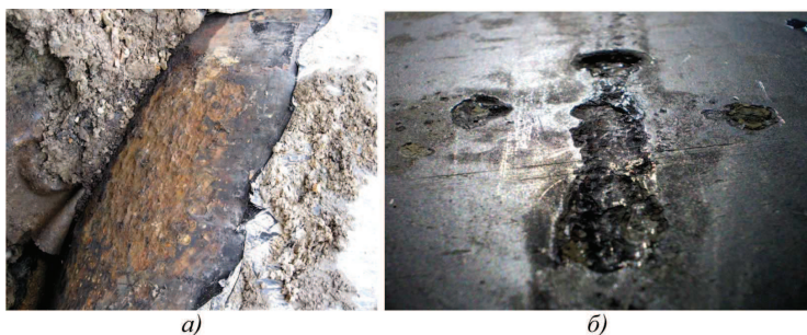
Рис. 1. Корозійні пошкодження підземних трубопроводів
