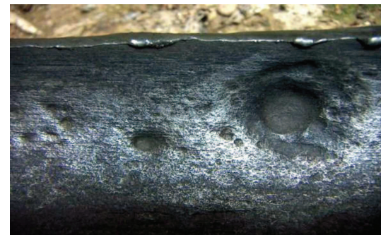
Рис. 2. Біокорозійні пошкодження внутрішньої поверхні трубопроводу діаметром 89 мм [4]
