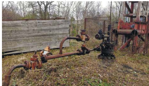
Рис. 4. Гирло свердловини № 2000 з від'єднаним шлейфом / Wellhead No. 2000 with a disconnected plume
