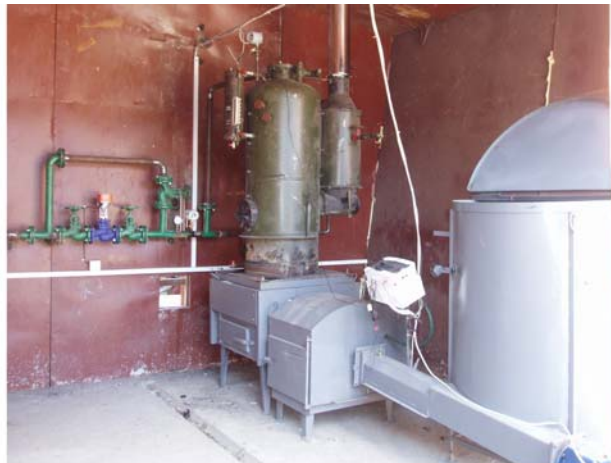
Рис. 2. Паровий котел в складі установки для пропарювання деревини
