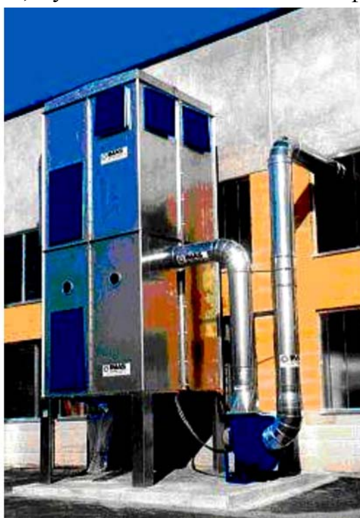
Рис. 6. Повітроочищувальна станція на базі рукавних фільтрів
